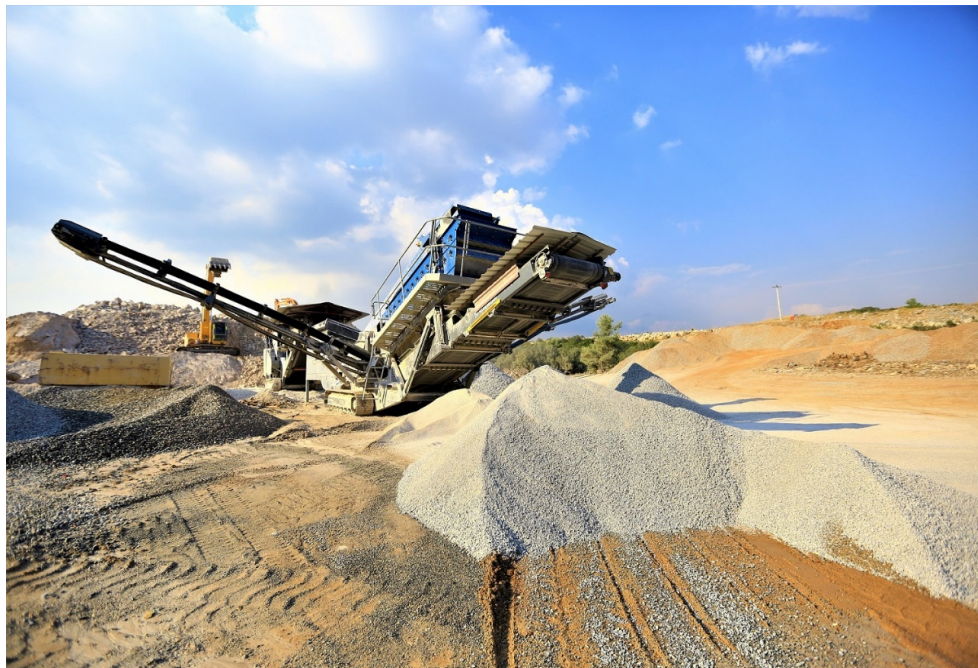
Paveikslėlis 1. 1. Muğla savivaldybės grunto kasimo ir statybos bei griovimo atliekų perdirbimo įrenginys.
