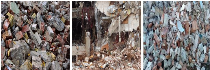
Şekil 3. 5. Karışık inşaat yıkıntı atıkları.
